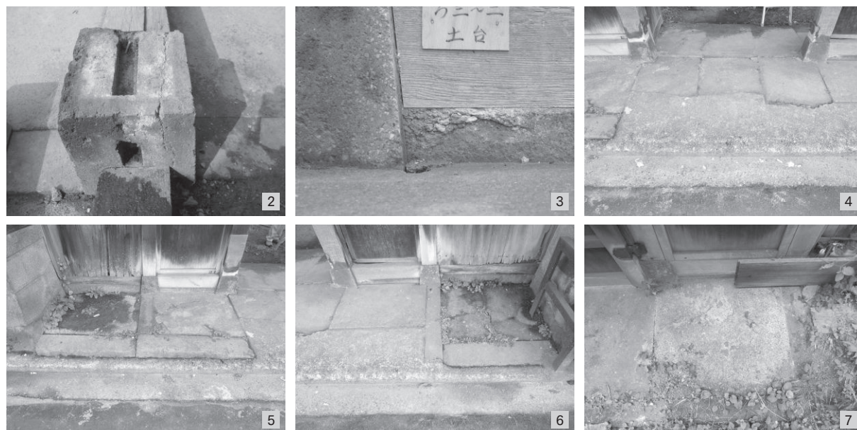
図9 | 基礎の破損概要
