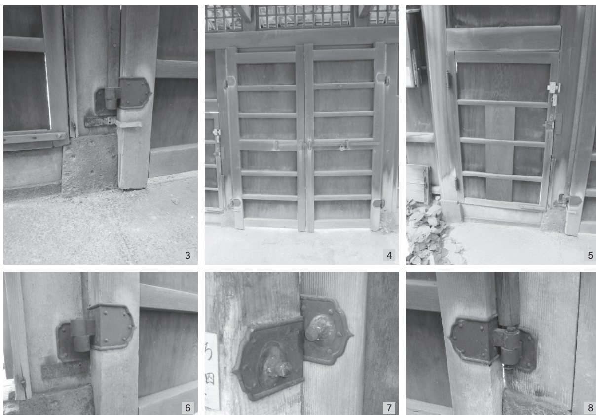
図15 | 建具の破損概要
